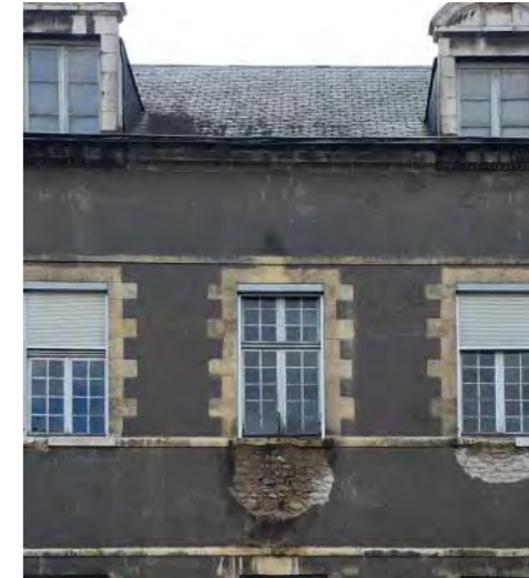
Dét. façade Ouest sur le bd J.Jaurès
